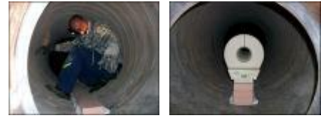
Praxis-Beispiel Dampfkessel in einer Brauerei
