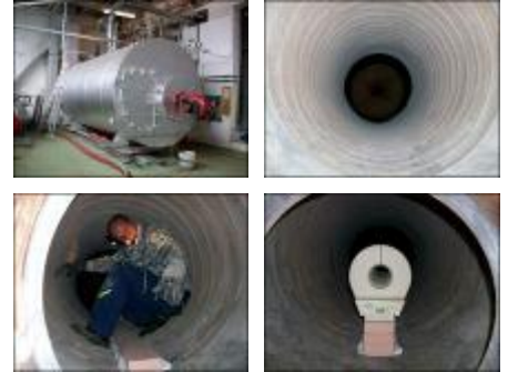
Praxis-Beispiel Dampfkessel in einer Brauerei
