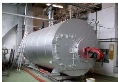
Heizkessel für Prozessdampf bei der Privatbrauerei Waldhaus
